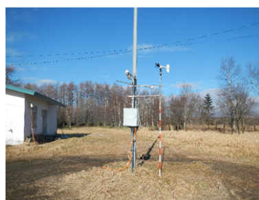
中標津町に設置した気象観測所
