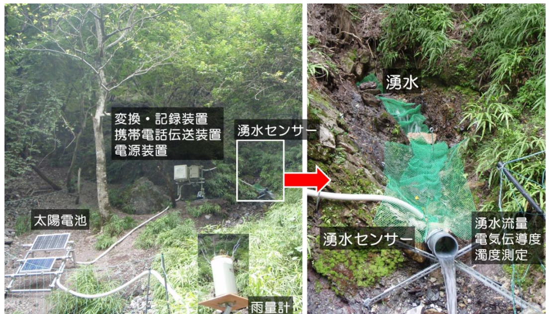
図 2-3 湧水センサーの設置状況
